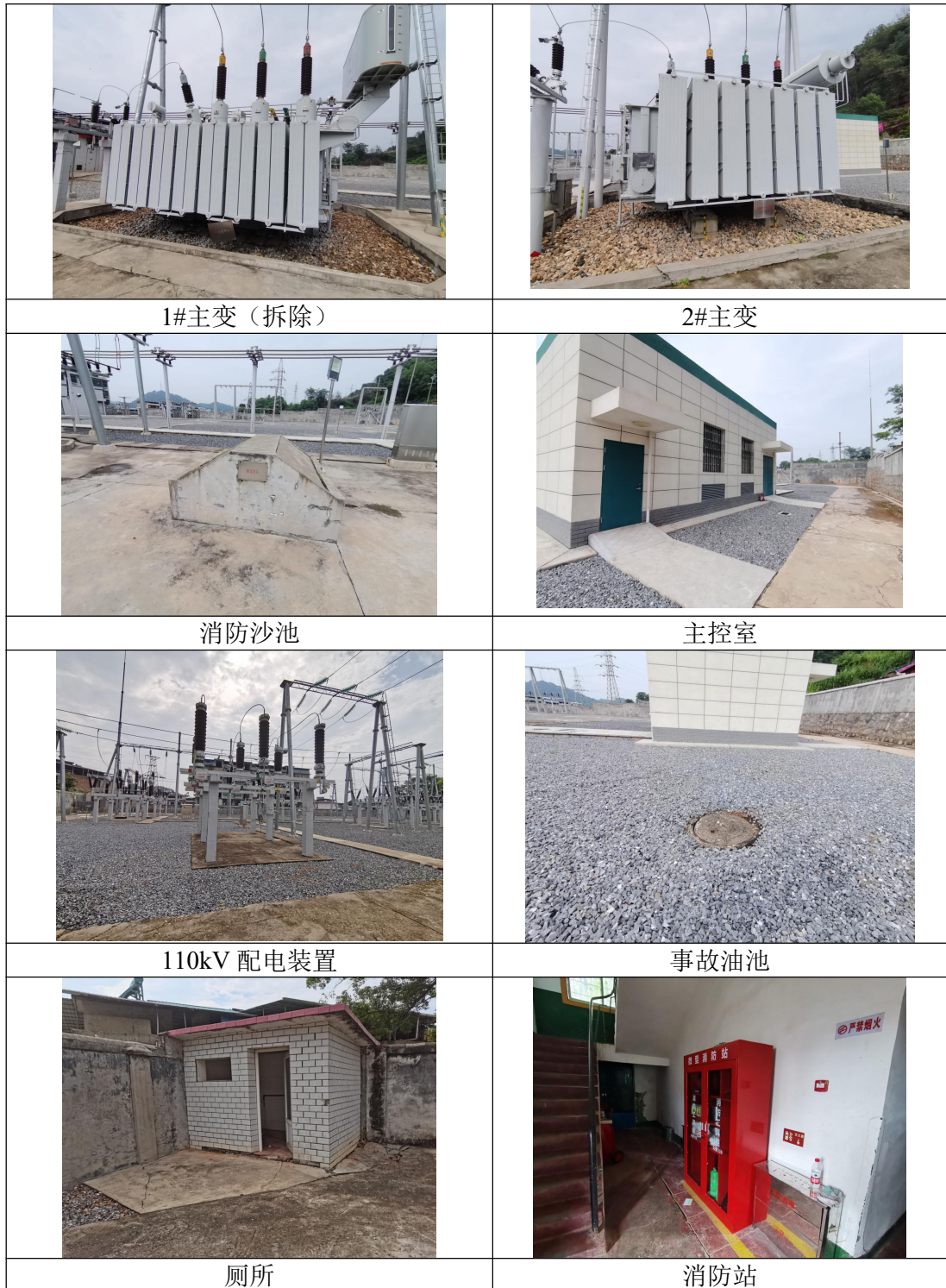
图 2-1 变电站站内环境现状
