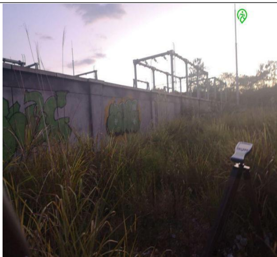
N4 变电站东侧
