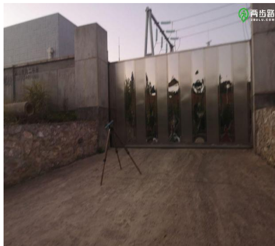
N1 变电站南侧
