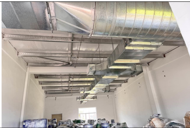
废气收集管道
