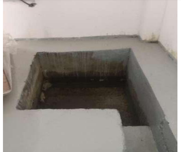
危废间事故池
