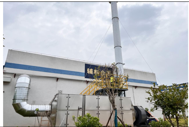
活性炭吸附+排气筒
